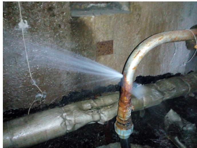
имеется течь из котла
