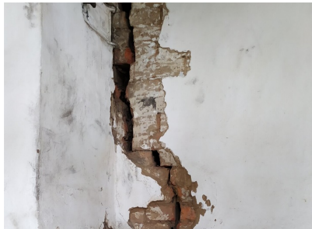
имеется сквозная трещина в печи
