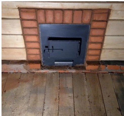
участок пола из горючих материалов (доска, паркет и другое) перед топочным отверстием печи не защищен негорючим материалом (металлический лист, плитка и т.д.)
