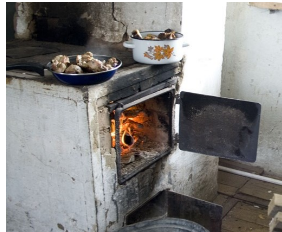
топочная дверца печи неисправна (не закрывается)
