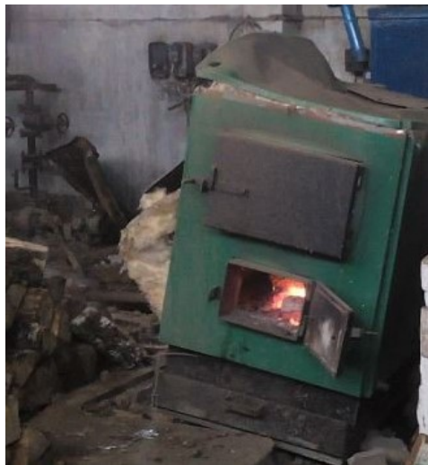
имеется механическое повреждение корпуса котла
